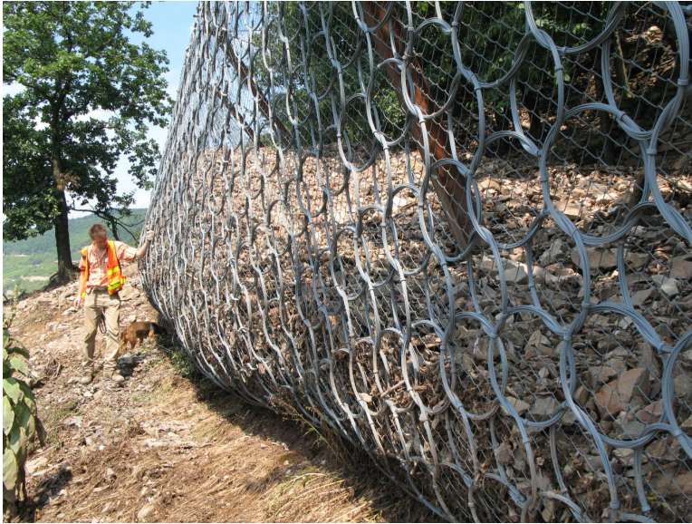
Bild 3: Fangzaun nach einem Murenabgang
